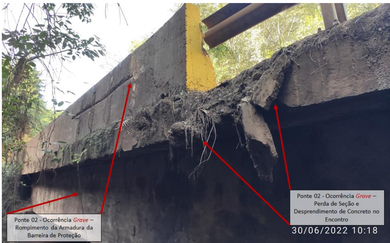
Figura 10 – Demonstrativo Qualitativo Exemplificativo das Manifestações Patológicas – Ponte 02 – Trecho Original - Fonte: Elaborado pelos Autores
