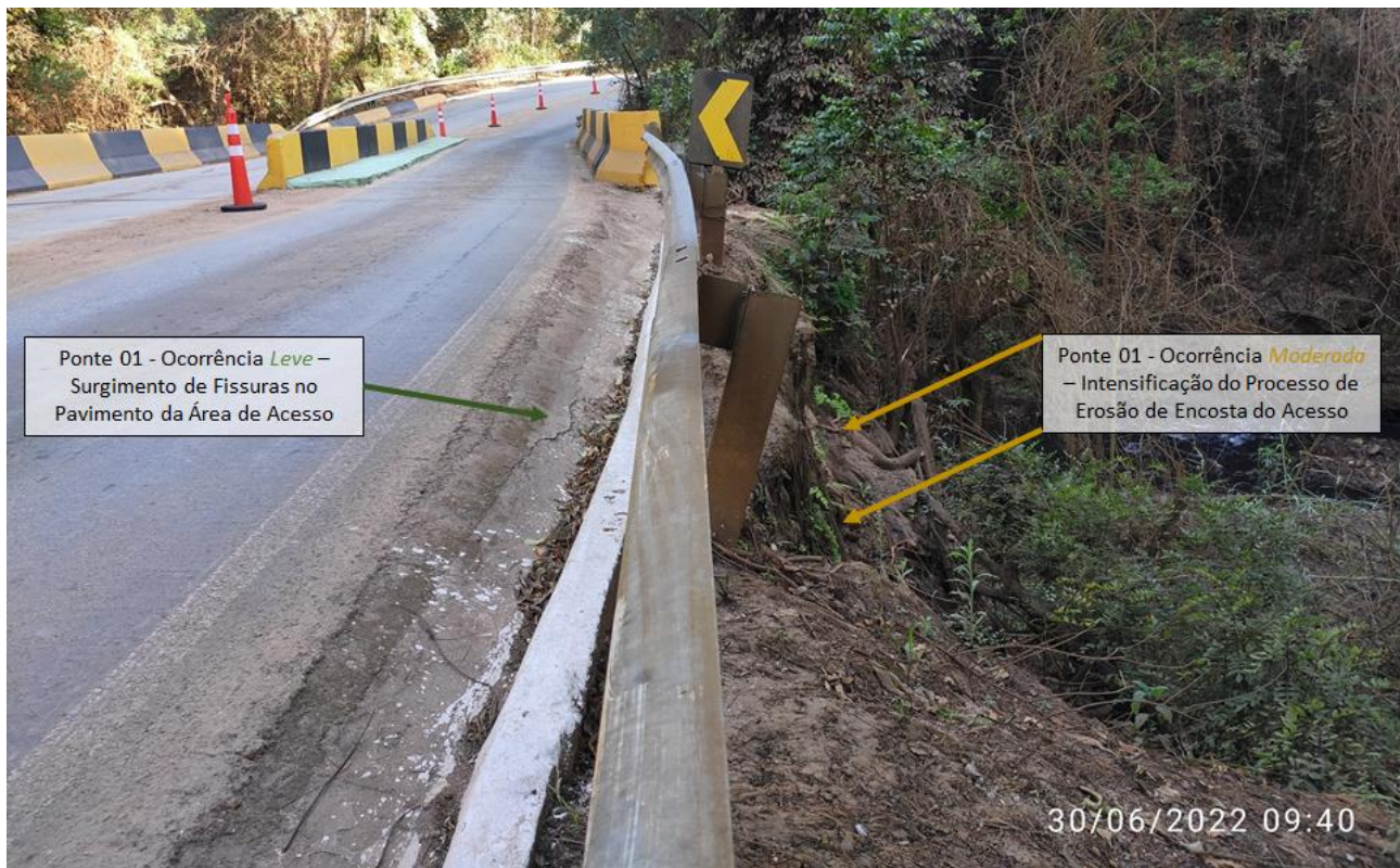
Figura 08 – Demonstrativo Qualitativo Exemplificativo das Manifestações Patológicas – Ponte 01 – Trecho Novo - Fonte: Elaborado pelos Autores
